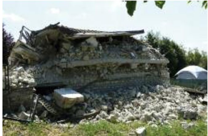
Fig. 3.3 Crollo edificio con muratura in pietra e solai pesanti (Cossito - 2016).
