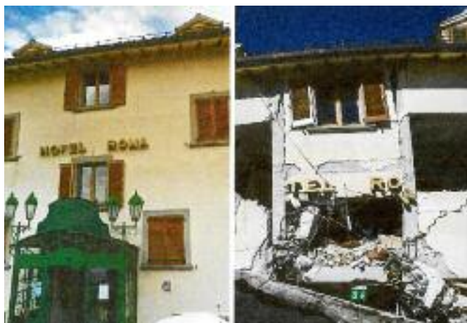
Fig. 1 Amatrice, Hotel Roma prima e dopo l'evento sismico. L'aspetto esterno tradizionale nascondeva un robusto telaio in armatura di cemento. Vi furono vittime.
