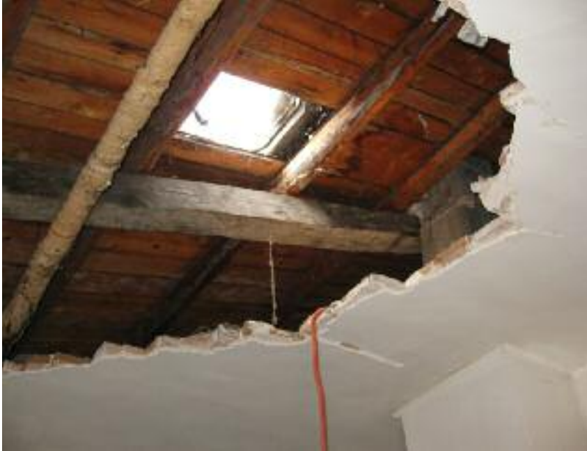
Fig. 6 Crollo di un soffitto di mattoni in foglio. L'esame immediato della meccanica del danno e la sua rubricazione sono strumenti idonei per rimuovere o ridurre le situazioni di rischio in previsione di eventi successivi.
