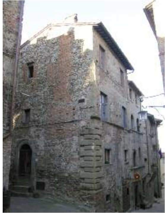
Fig. 3 Muratura disomogenea, ogni intervento di trasformazione nel sodo murario può compromettere l'omogeneità della muratura, Anghiari (AR).
