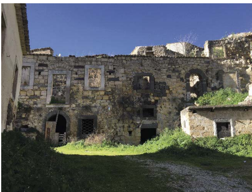
Figg 7 e 8 Alcuni edifici del borgo dove risulta evidente lo stato di degrado e di totale abbandono.
