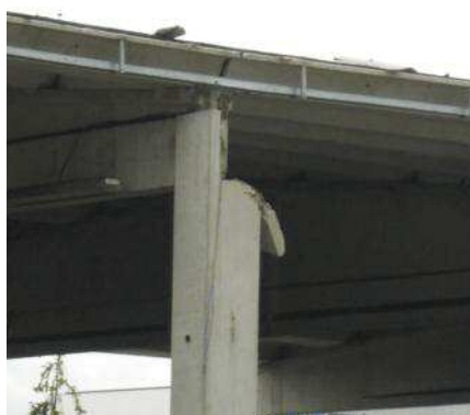
Fig. 3.1 Esempio crollo capannone con collasso del collegamento (Mirandola 2012).
