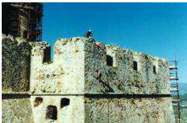
Da sinistra: Fig. 18 Opere di stabilizzazione del bastione dell'ospedale con l'impiego di rocciatori specialisti.
