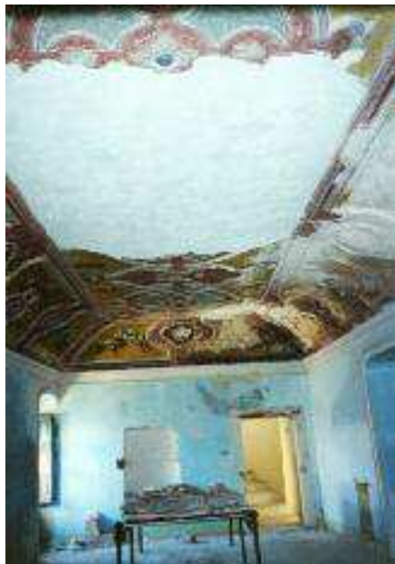
Fig. 23 Volta dell'incannicciata prima dei lavori.
