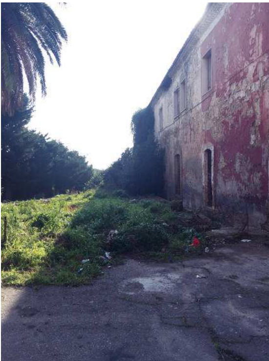
Fig. 2 Facciata di nord-est: stato di degrado.
