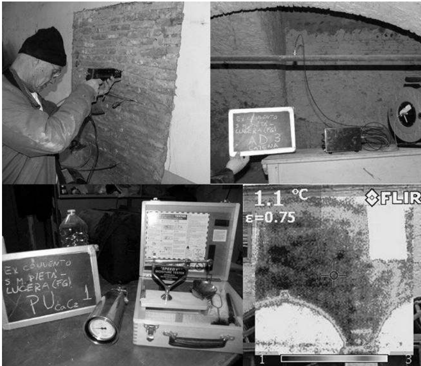
Fig. 10 Alcune delle prove effettuate ed analisi termografica delle facciate.
