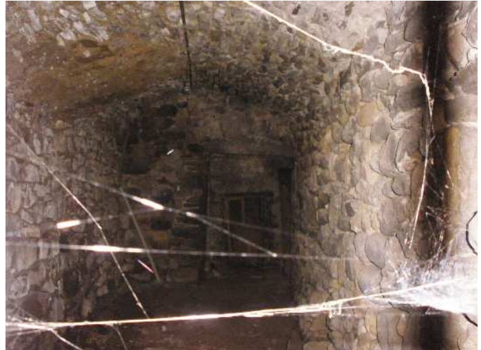
Fig. 3 Passaggi voltati che creano nella loro continuità delle vere e proprie gallerie, Caprio, comune di Filattiera (MS).
