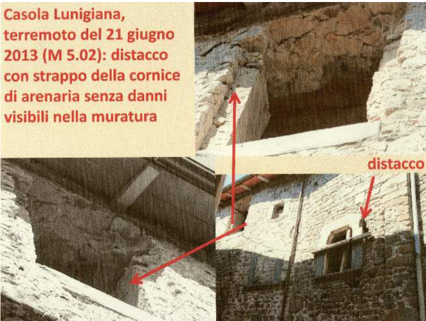
Fig. 4 Casola Lunigiana, distacco delle cornici delle finestre senza danno al corpo dell'edificio (terremoto del 21 giugno 2013, M Richter 5.2).
