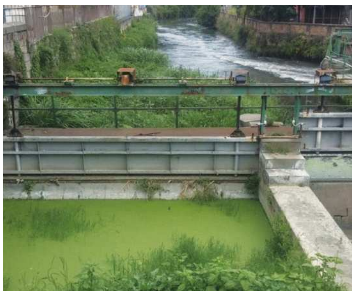
Fig. 2 Le chiuse della traversa idraulica di Scafati, nel centro città, definitivamente davvero chiuse e nel degrado.
