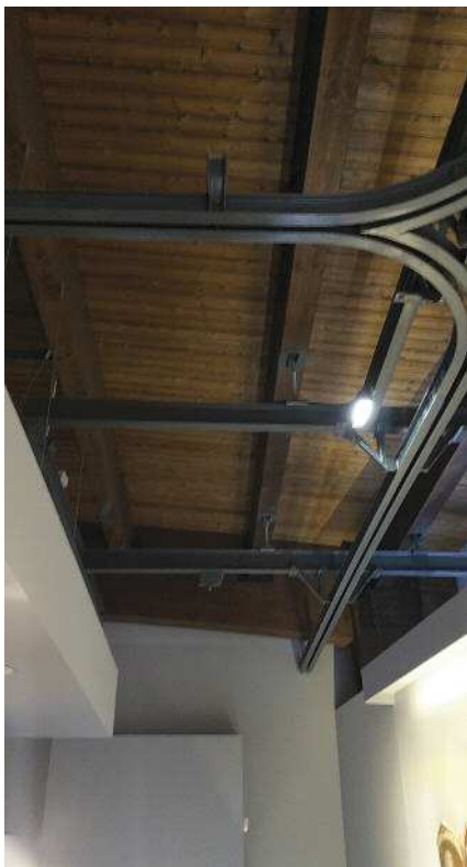
Fig. 15 Sala F. La struttura di copertura non è stata occultata con un telo termoteso come previsto, risultando invasiva rispetto all'allestimento.
