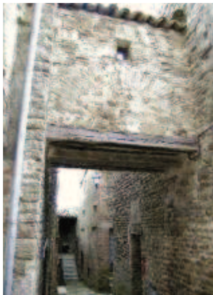
Fig. 9 Corpo di contrasto edificato, Monterone, frazione di Sestino (AR).
