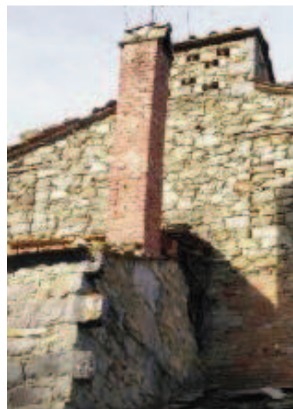
Fig. 10 Comignolo soggetto a caduta libera in caso di terremoto, Ca' del Tasso, frazione di Caprese Michelangelo (AR).
