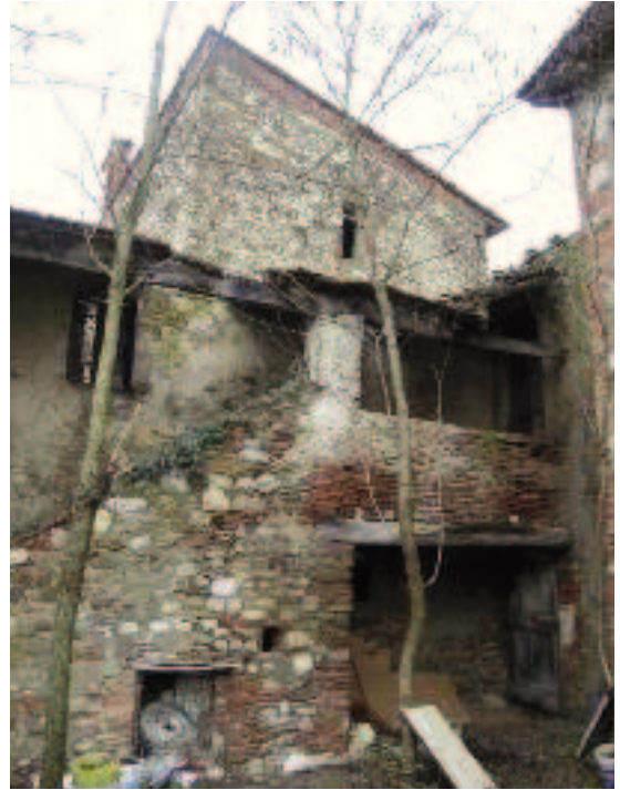
Fig. 5 L'incremento della vulnerabilità in caso di abbandono è un fenomeno noto e difficilmente avviabile con interventi amministrativi, Santa Croce, frazione di Sansepolcro (AR).
