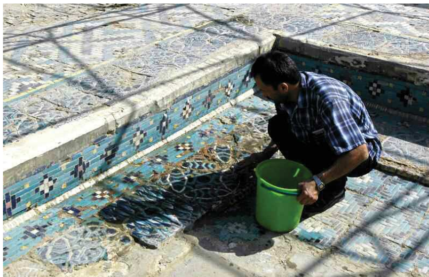
Fig. 7 Shahrisabz (Ouzbékistan), Un des bassins de l'Ak Saray, dégradé par des conditions météorologiques extrêmes durant l'hiver 2007-2008 (ici Dr Babur Aminov, Tachkent; ph: M. Schvoerer, 2008).
