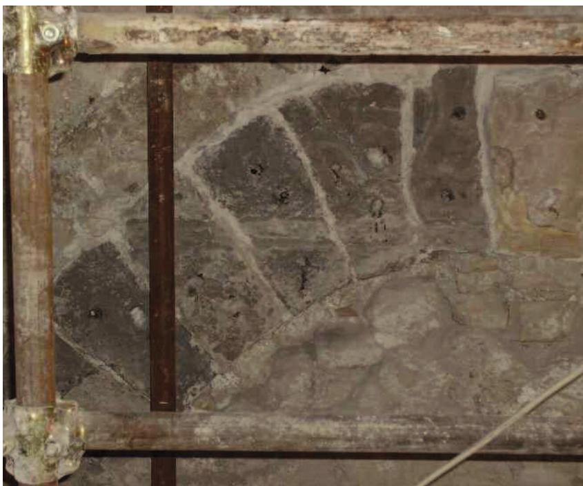
Fig. 5 Chiesa di S. Salvatore de' Birecto ad Atrani. Esempio di restauro in atto di arco con rinforzi di tufo grigio e malta (fonte Luciano Russo)
